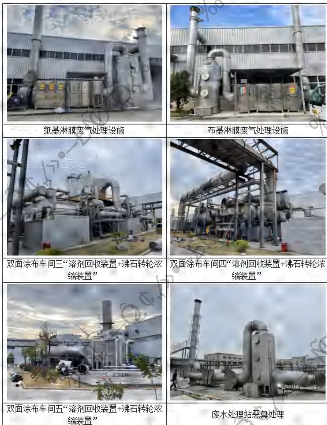
图 4.1-4 有组织废气治理设施
